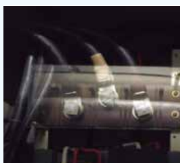
配線異常發熱
