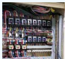
控制盤內機器異常發熱
